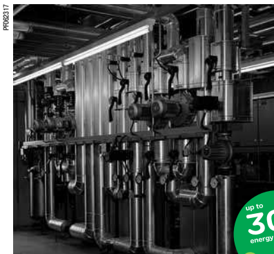
Управление насосной станцией
